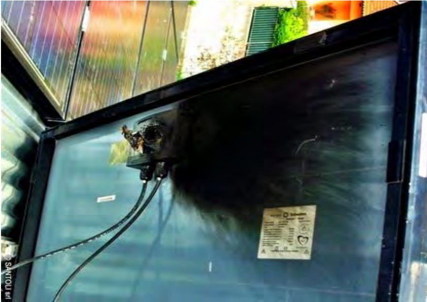
Principio di incendio scaturito dalla scatola di giunzione
